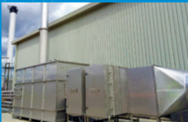
Instalacja Centriair o wydajności 10.000 m 3 /h z reaktorem UV, filtrem z węglem aktywnym oraz wentylatorem i instalacją wywiewną
